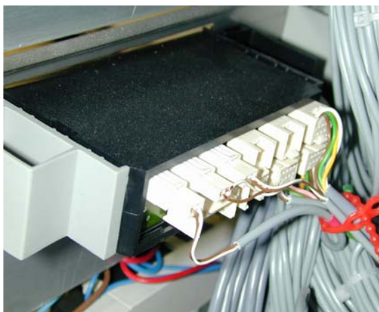
Aansluitingen voor prefab kabels
